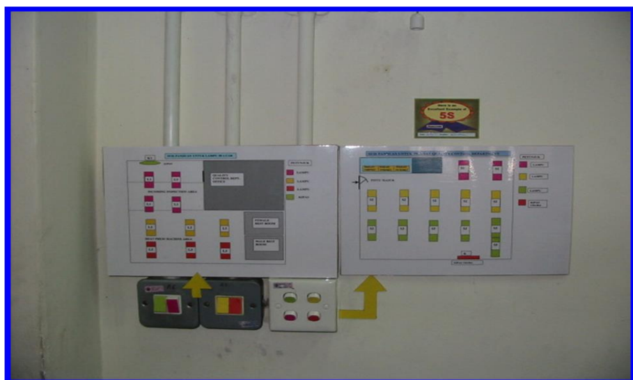
Hình 48: Bảng công tắc điện và hướng dẫn vận hành theo màu sắc, hình ảnh trực quan chỉ rõ vị trí các đèn
